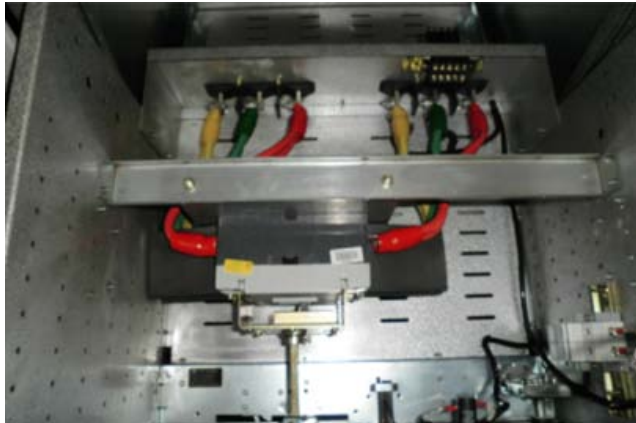
出线 6 抽屉照片
