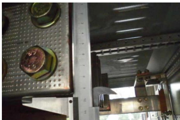
水平母线宽度照片
