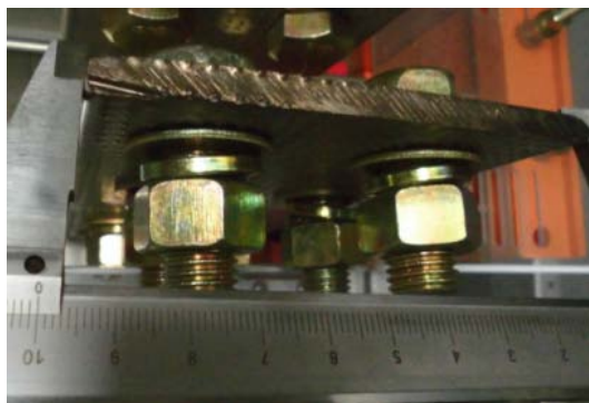
配电母排宽度照片
