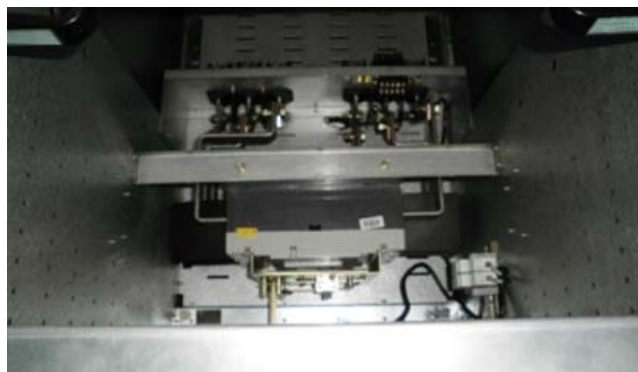
出线 7 抽屉照片
